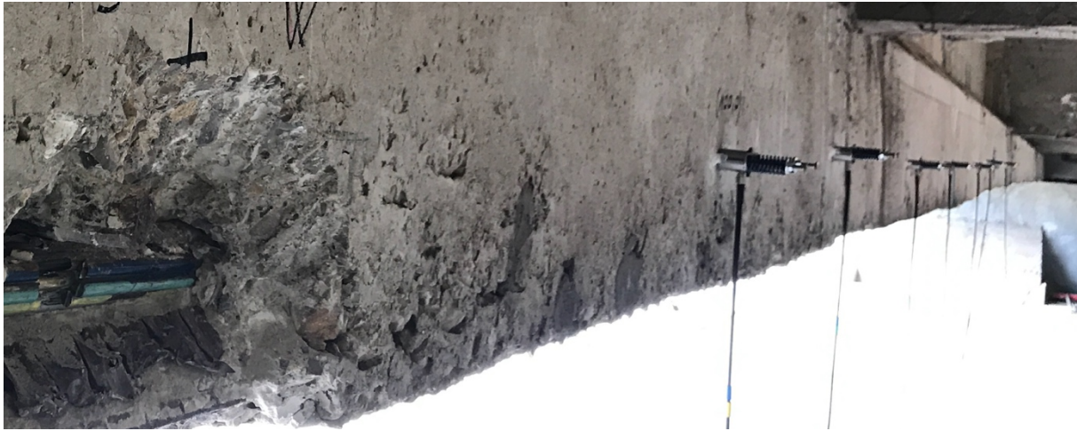
Figura 8.1: Prova sperimentale di individuazione dell'evento di rottura di un filo di precompressione in un ponte a grigliato in CAP con sensori di emissione acustica. In questo esperimento l'evento è stato rilevato fino a circa 10m dal punto di rottura (foto e prova SISCON - Politecnico di Torino).
